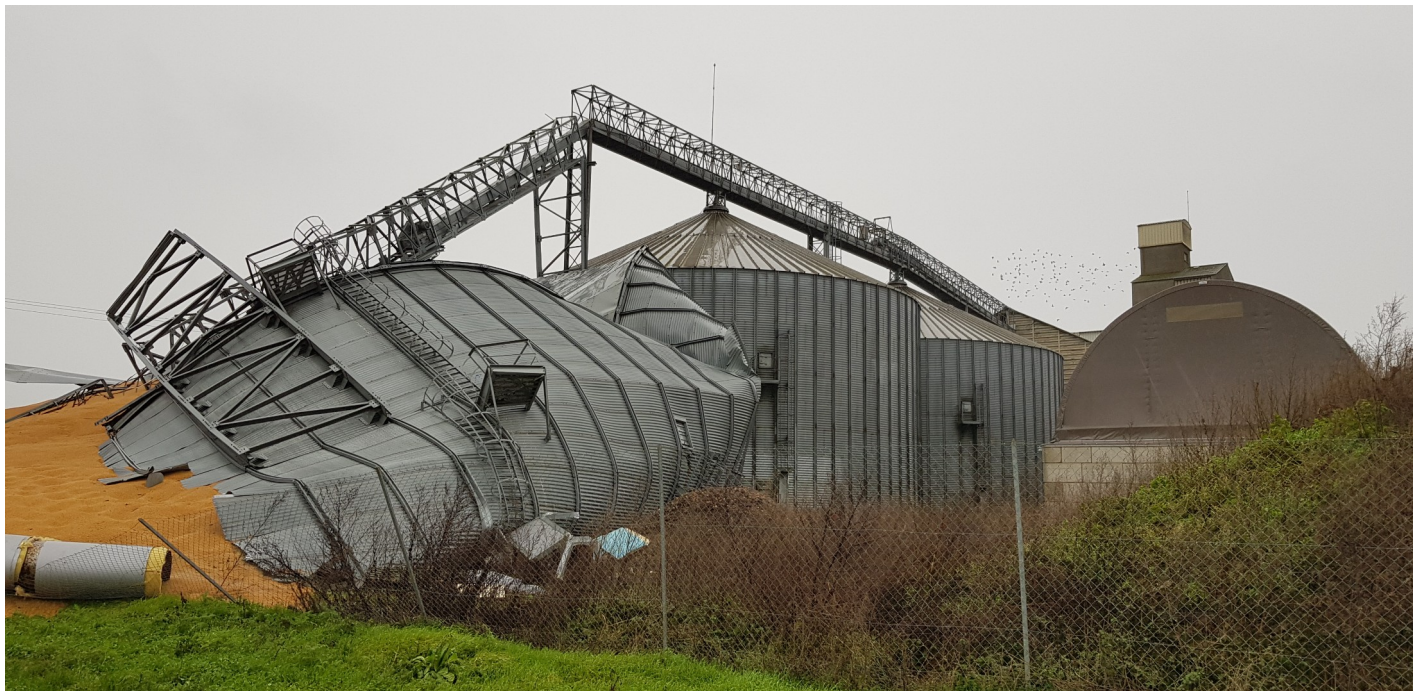
Éventrement d'un silo de céréales à Houville-la-Branche (28)
